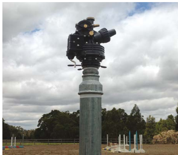
Zainstalowany Rotor ST-1600-HS-BR
