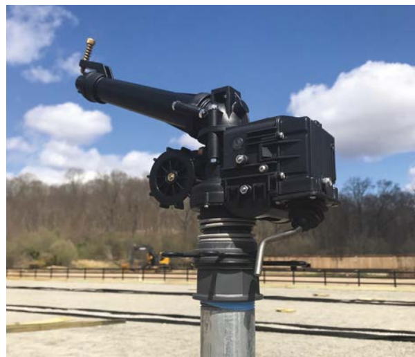
Zainstalowany Rotor ST-1200-BR
